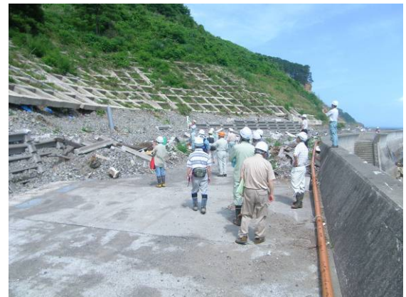
久慈市麦生地区(被災した法枠工)
