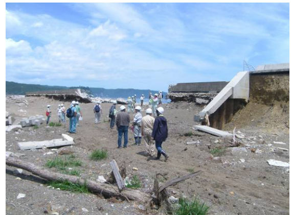
野田村前浜地区(破壊された防潮堤)
