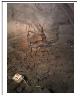
切羽は粘板岩 ※硬質だがクラックが多く 剥離性高い
