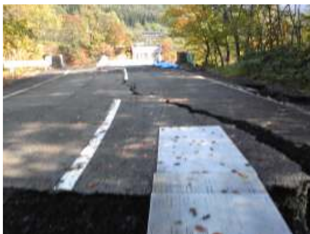
写真 2 地すべりによって損壊した右岸側道路
