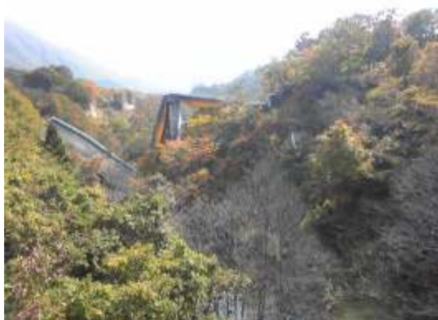
写真 1 落橋した祭時大橋
